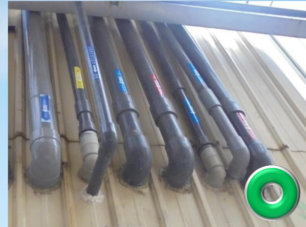
管線分類標示
