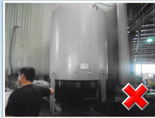
未設置防溢堤
