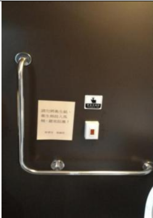
廁間設扶手及緊急求助裝置。
