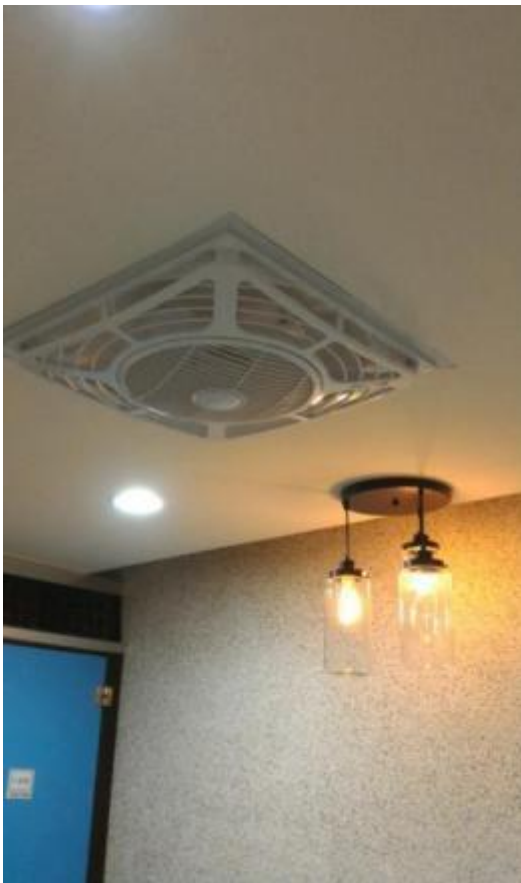
廁所內採機械換氣，減少廁所臭味。
